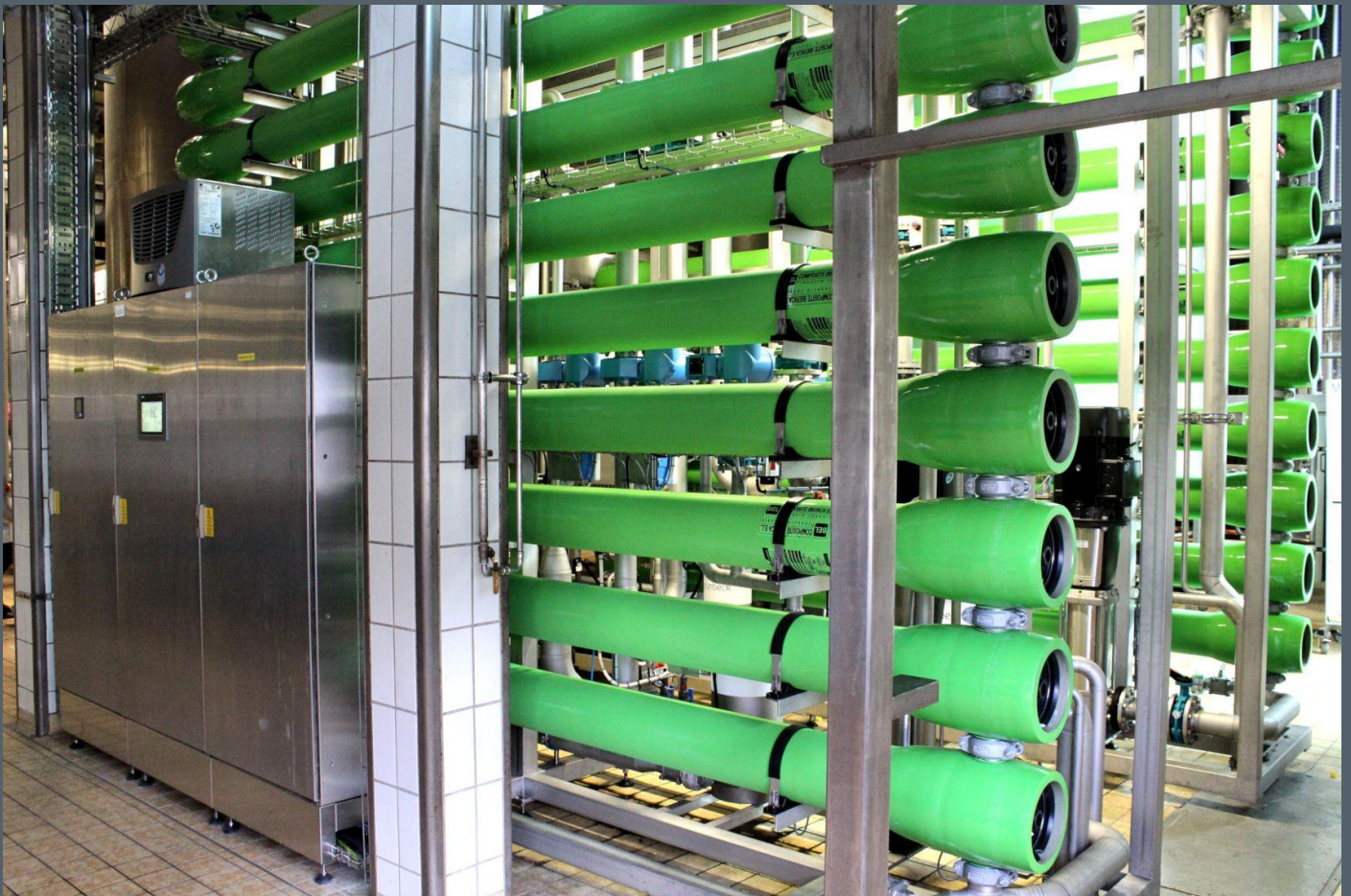
Schaltschrank und Umkehrosmoseanlagen
