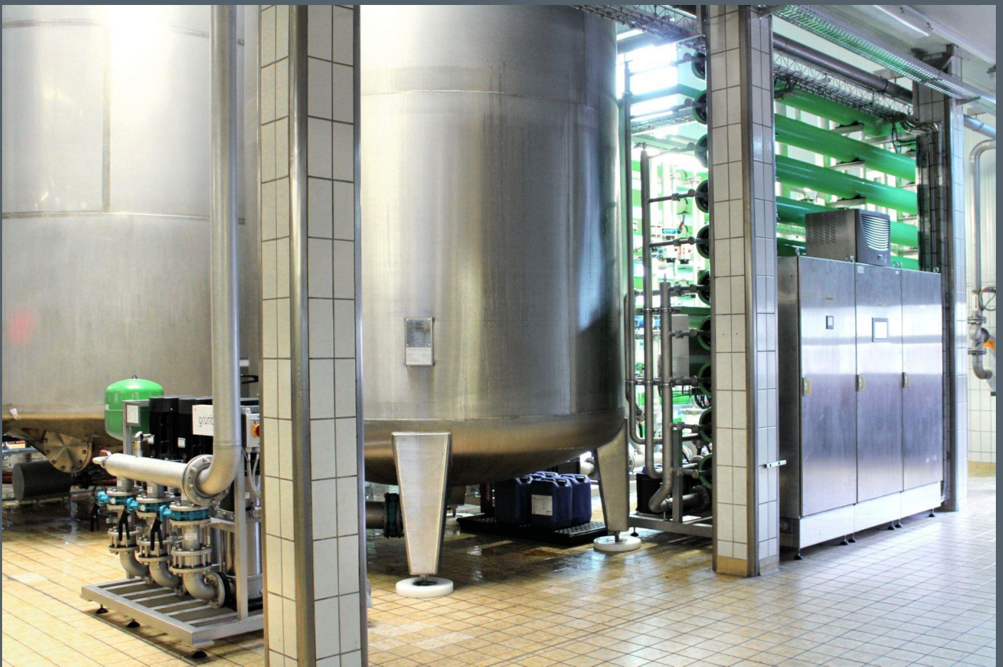
Reinwassertank und Druckerhöhung
